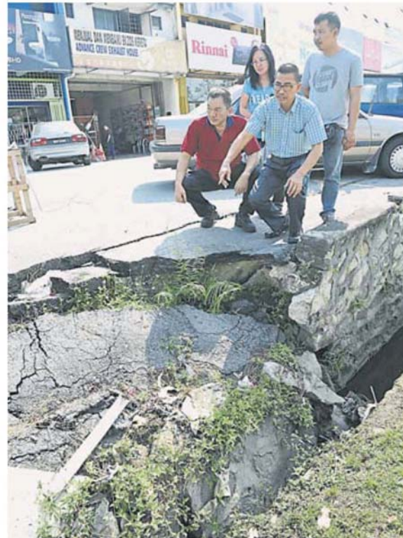
余保凭 (前排右起) 和居民一起巡视沟渠坍塌问题。
