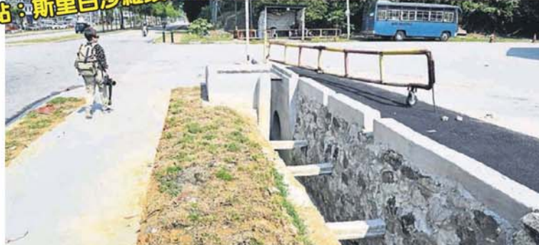
■其中一个坍塌处已在两周前修复。
