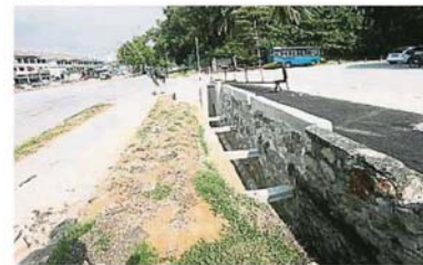
八打灵再也市政厅在沟渠崩塌处仅有约10公尺的沟渠进行修复，惟严重的部分却尚未处理。
