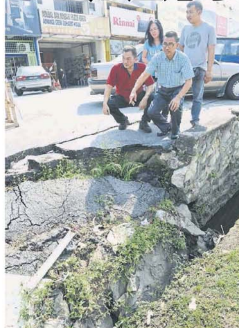
■余保凭(前排右起)陪同居民，巡视斯里白沙罗镇SD5/1B路的沟渠坍塌问题，促请有关当局尽快展开修复工作，后左为居民辛佩菁。
