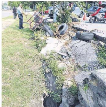
■斯里白沙罗镇SD5/1B路的沟渠坍塌阻挡排水系统，导致毗邻的主要道路逢雨必灾。
